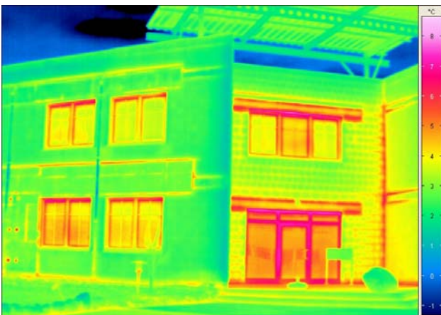
Bild 2: Außenthermografie – Innenecken als geometrisch bedingte Wärmebrücken, undichte Fensterdichtungen, deutlicher Wärmeverlust im Bereich der Türrahmen und Mörtelbrücken sichtbar
