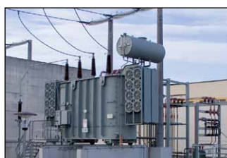
Realbild eines Transformators
