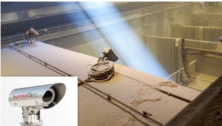
Abb. 1: Zur Überwachung des Einfülltrichters kommen fest installierte Wärmebildkameras zum Einsatz.
