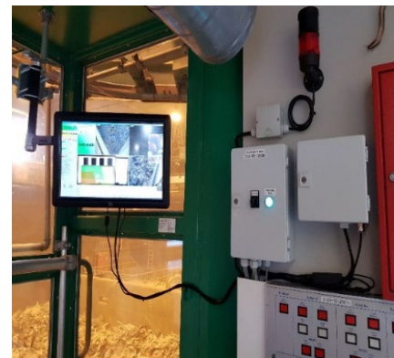
Abb. 4: Monitoring in der Krankanzel und Alarmierungseinheit
