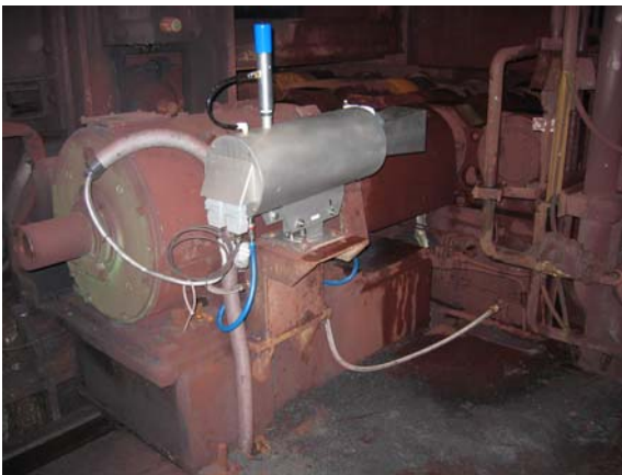
Abb. 2: Automatisiertes Thermografie-Messsystem INDU-SCAN zur Prozesskontrolle – Kontinuierliche Temperaturüberwachung bei der Blechherstellung, anlagennahe Installation der Thermografiekamera im Schutzgehäuse mit Wasserkühlung und Freiblaseeinrichtung
